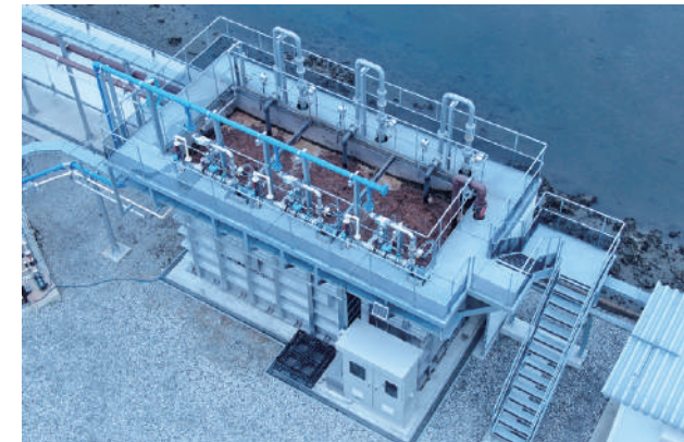
● 排水を高レベルで浄化する膜分離活性汚泥装置「MBR」
